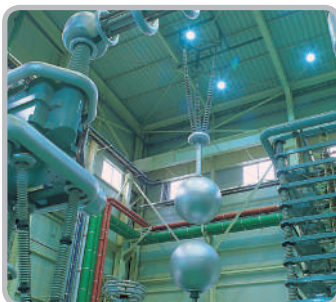
Испытание импульсом в лаборатории высоких напряжений
