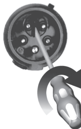
Рис. 17 Смена фаз трёхфазного шкафа управления с фазовым инвертером
